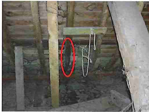
Waterinsijpeling aan linkerzijde dakluik.
