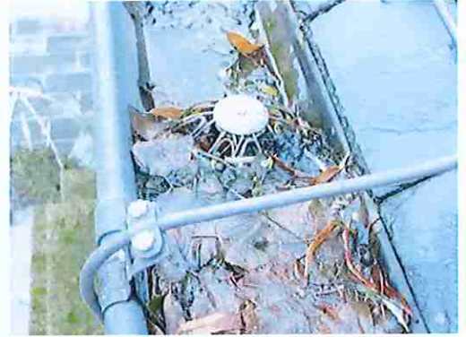
Zuidzijde; verstopping door bladeren.
