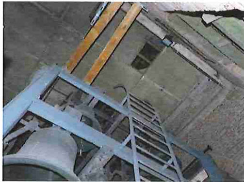
Ontoereikende ladder naar torenzolder.
