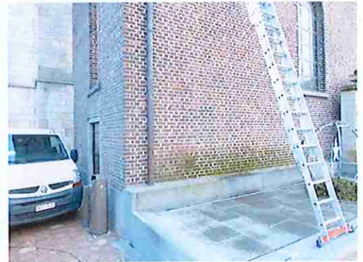
Zuidzijde; natte muren door overlopende goten.
