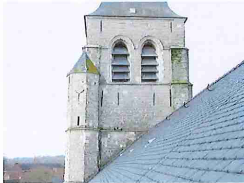
Toren: geen goten of afvoeren.
