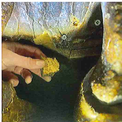
basis: een vermolmd stuk hout is afgebroken, schroeven zijn in het hout geschroefd met errond scheurtjes.
