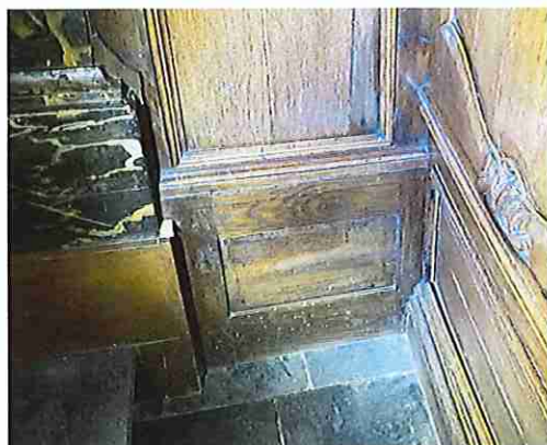
lokaal verkleuringen als gevolg van vochtbelasting
