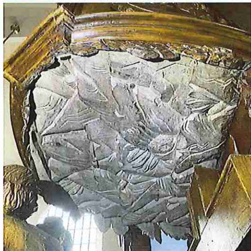
onderzijde kuip is matter van aard, een afwerking ontbreekt
