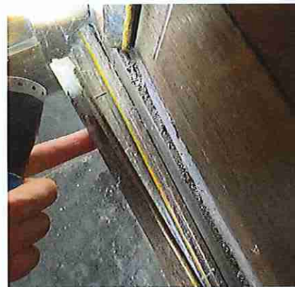
onderaan in de hoek is een horizontaal lijstje deels gelost
