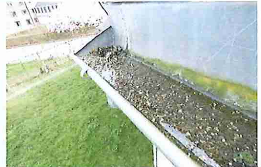
overlopende goot door verstopping tapgat
