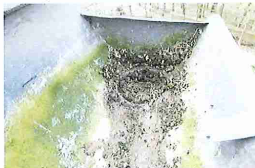
na wegscheppen van het vuil in de goot bleek de onderliggende afvoer een heel eind verstopt met vuil
