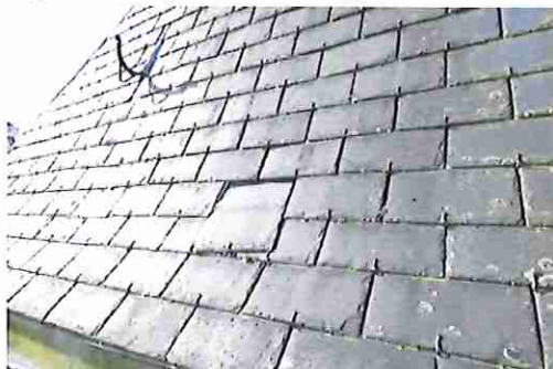
uitgeschoven/ gebroken lei; nadien vervangen
