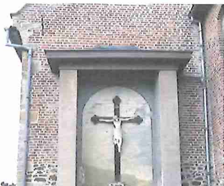
situatie: bakgoot helt af naar links (zuidzijde) terwijl de afvoer zich rechts bevindt
