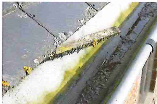
losgekomen tengellat, nadien teruggeplaatst
