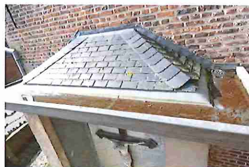
opgehoopt water geraakt niet bij de afvoer door foutief afschot van de bakgoot
