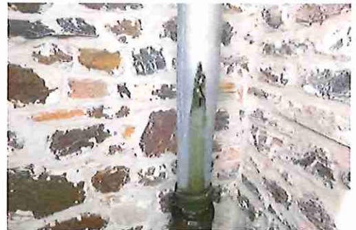
door vuil kapotgevoren afvoer
