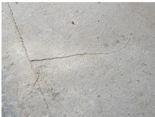
scheur in betonvloer
