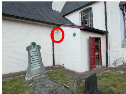
Lokalisatie geplaatste scheurmeter
