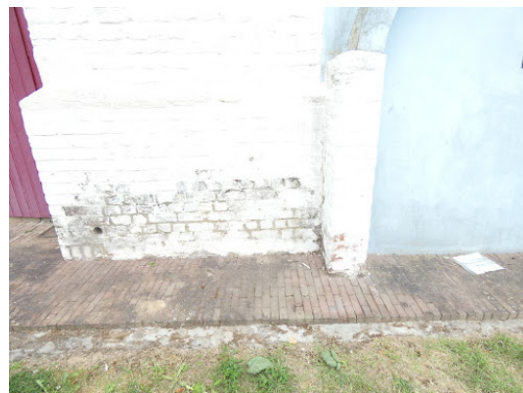
schade door spatwater, afkomstig van het dak van de calvarie
