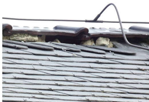
2) uitgevallen aanstrijkmortel nokpannen
