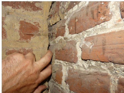
scheur langs binnenzijde
