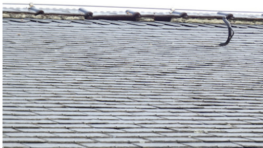
2) uitgevallen aanstrijkmortel nokpannen
