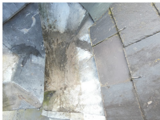
zalinggoot na reiniging door Monumentenwacht
