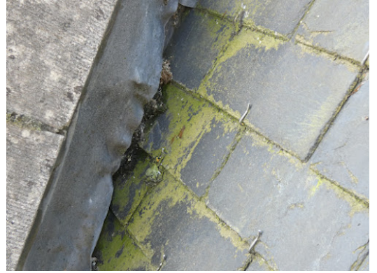
vastgehecht vuil onder loden aansluiting tegen het opgaand muurwerk
