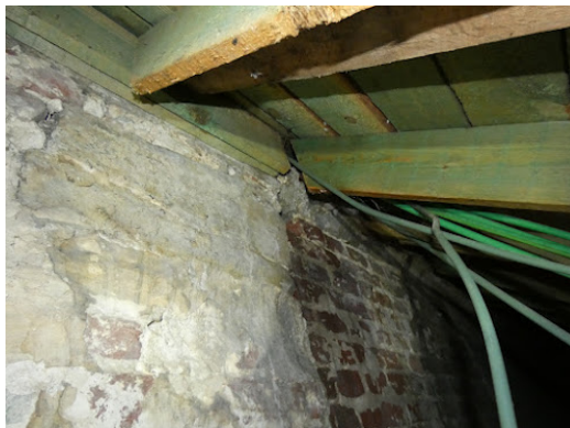
1) waterinfiltratie op zolder boven sacristie
