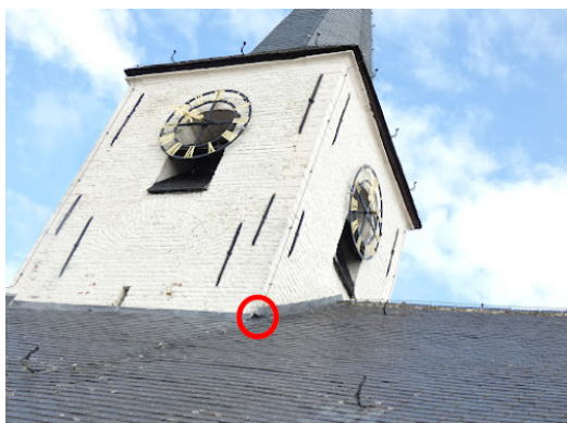
1) openstaande loden aansluiting aan zuidoosthoek van de toren
