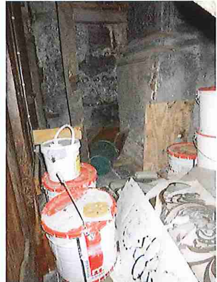
bergruimte onder doksaaltrap: aangetast hout
