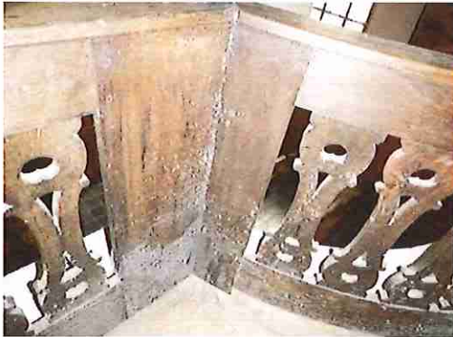
oppervlakteschimmel aan de achterzijde van de balustrade
