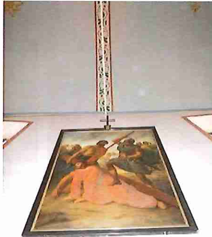
blindslag van de verf (vlekkerig)
