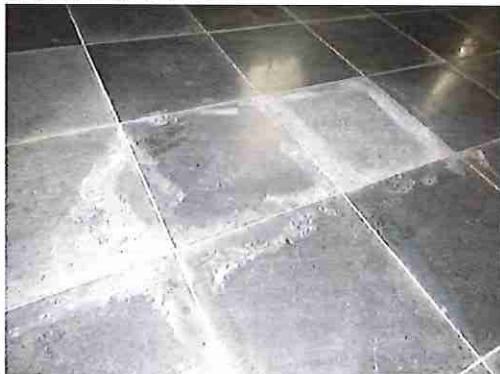
mattering/beginnende degradatie van het oppervlak
