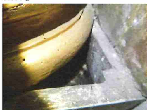
detail binnenzijde: boormeel
