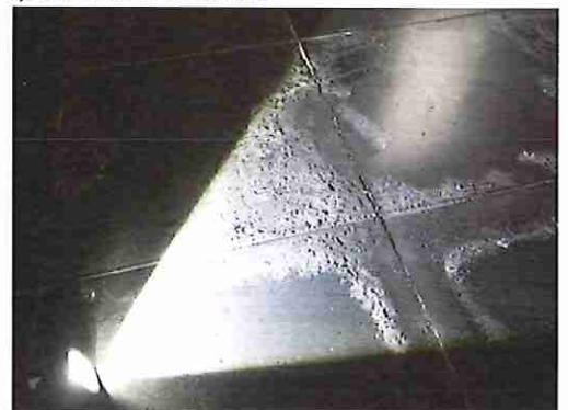
detail degradatie: afschilfering van het oppervlak
