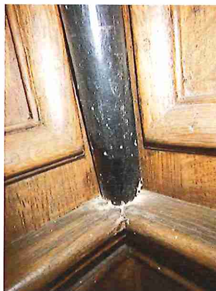
flambeeuwstok onderaan aangetast: uitvliegopeningen en boormeel
