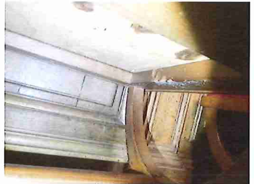
oppervlakteschimmel aan de onderzijde
