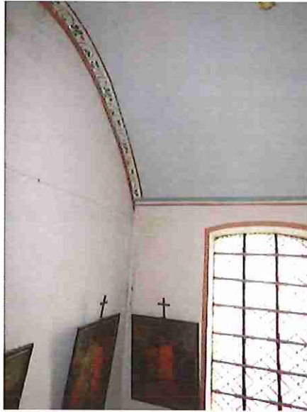
uitzakkend vocht westgevel
