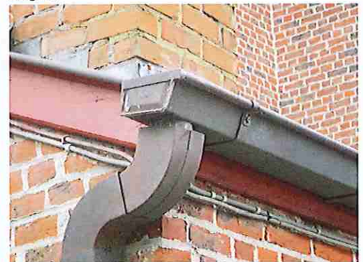
hanggoot en afvoer
