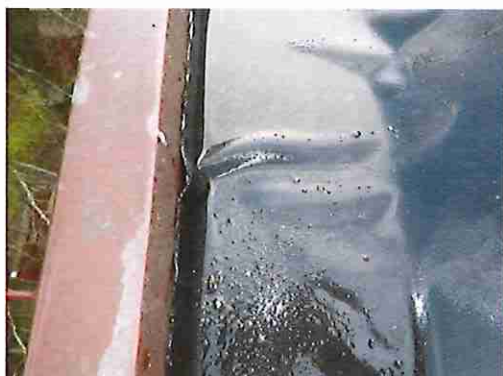
epdm sluit niet aan en staat open
