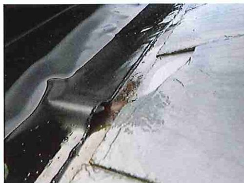
epdm sluit niet aan en staat open/inloop van water mogelijk
