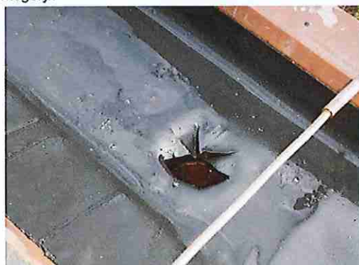
afvoeropeningen slordig uitgevoerd
