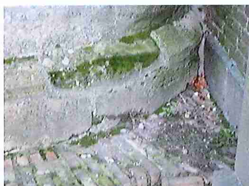
onderliggend metselwerk metselwerk-vochtbelasting
