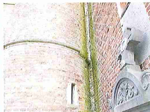
onderliggend metselwerk metselwerk-vochtbelasting
