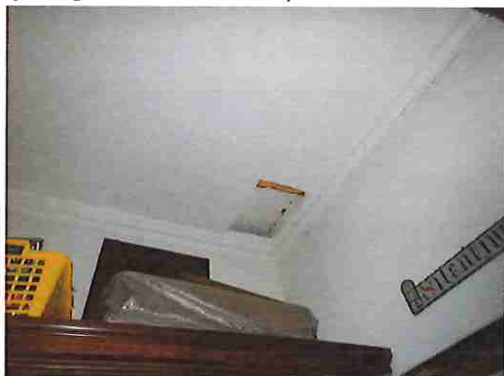
sacristie-geen degelijke toegang naar luik
