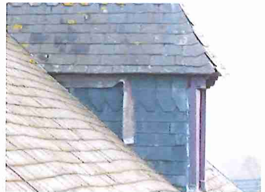
zuidelijke dakkapel-losgekomen slab
