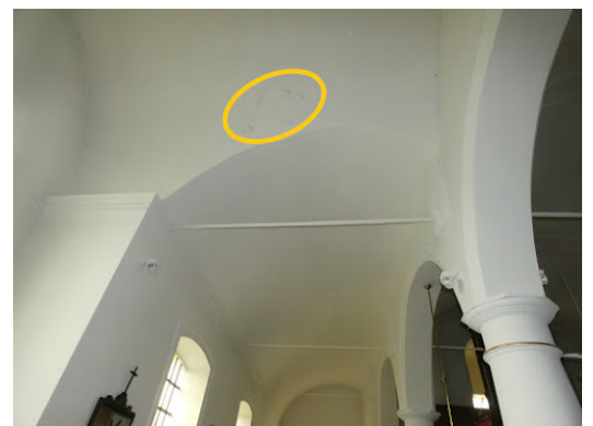
Lokalisering van de gevolgschade door waterinsijpeling aan het stucplafond van het zuidelijke transept, voor het Sint-Lambertusaltaar.
