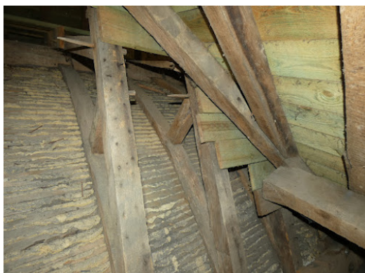
Toestand op de zolder van het dakbeschot rond de kilkeper: op het moment van de inspectie opgedroogd.
