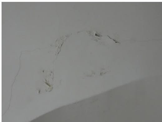
Detail van de gevolgschade aan het stucplafond.
