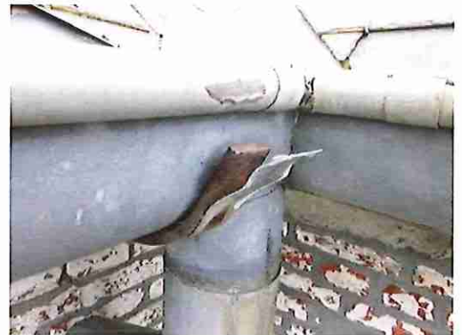
Detail verroeste gootbeugel met losgescheurde aanhechting.
