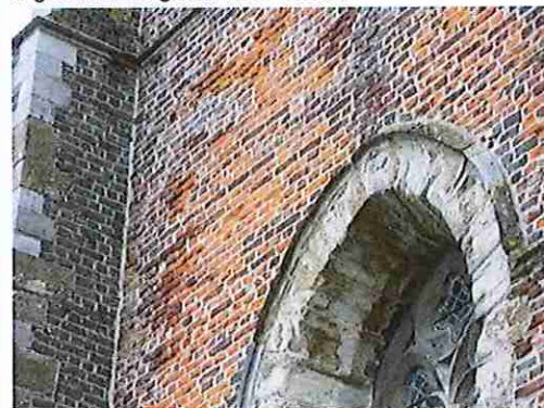
Afschilferende bakstenen toren.
