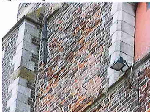
Afschilferende bakstenen toren.
