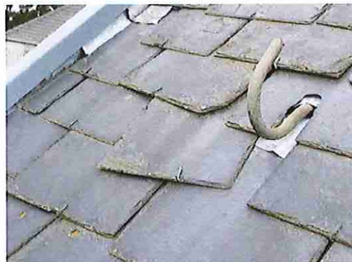
Niet genormeerde ladderhaken op het dak van het schip.
