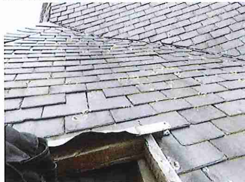
Dakkader onderste torenluik: te weinig opstand.
