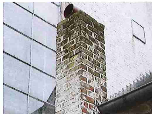
Uitgevallen voegwerk schoorsteen.
